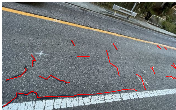
写真-1 上り車線の路面状況
