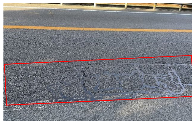
写真-2 下り車線の路面状況
