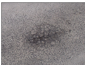
写真-3 舗装の亀甲状ひびわれ(3径間目)
