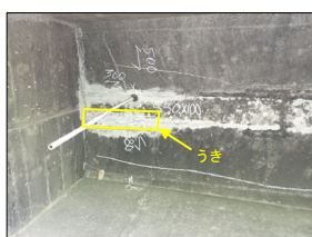
写真-12 床版のうき、 遊離石灰 (A1 部)
