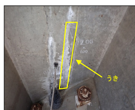
写真-4 間詰床版のうき、遊離石灰(P3付近)
