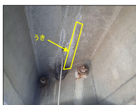
写真-13 床版のうき、 遊離石灰 (P3 付近)
