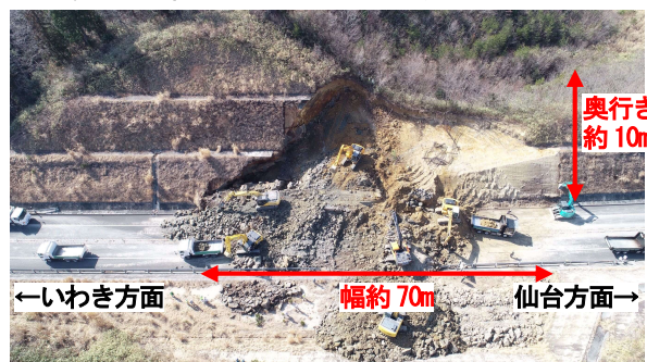
写真-1 法面災害の発生状況 2)
