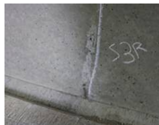
写真-3 誤検出例(遊離石灰①)
