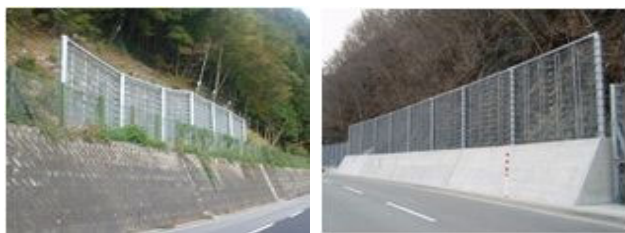
図-4 高エネルギー吸収型落石防護柵
